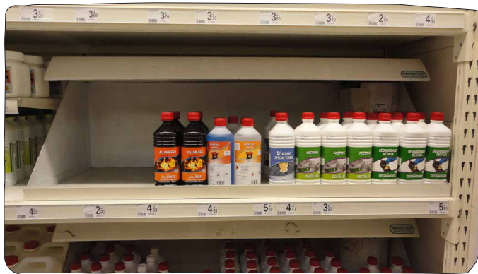
Étagère de stockage des produits inflammables avec rétention et dispositif d'extinction automatique
