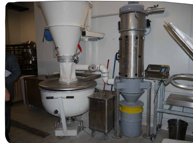
Pétrin équipé d'une aspiration des poussières de farine à la source
