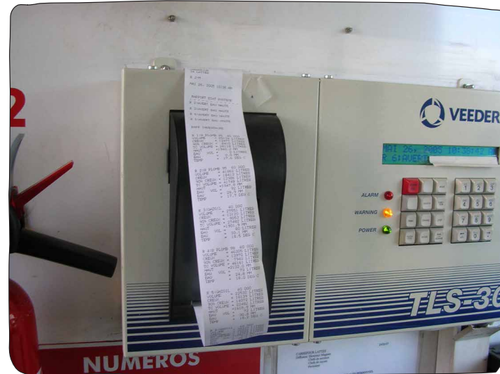
Contrôle électronique des niveaux des cuves
