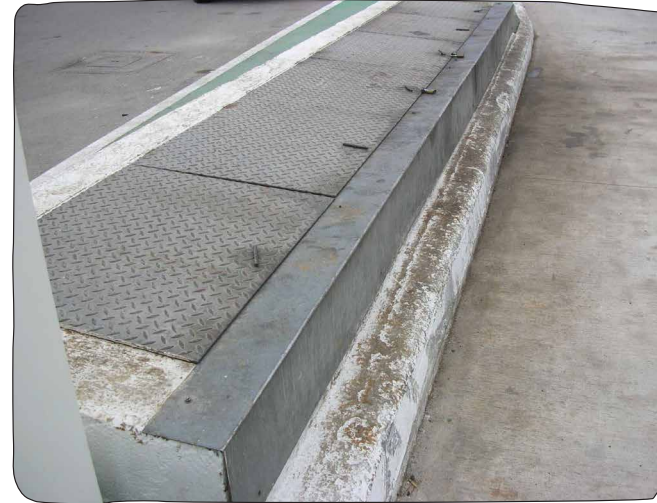
Glissière de protection de la cabine
