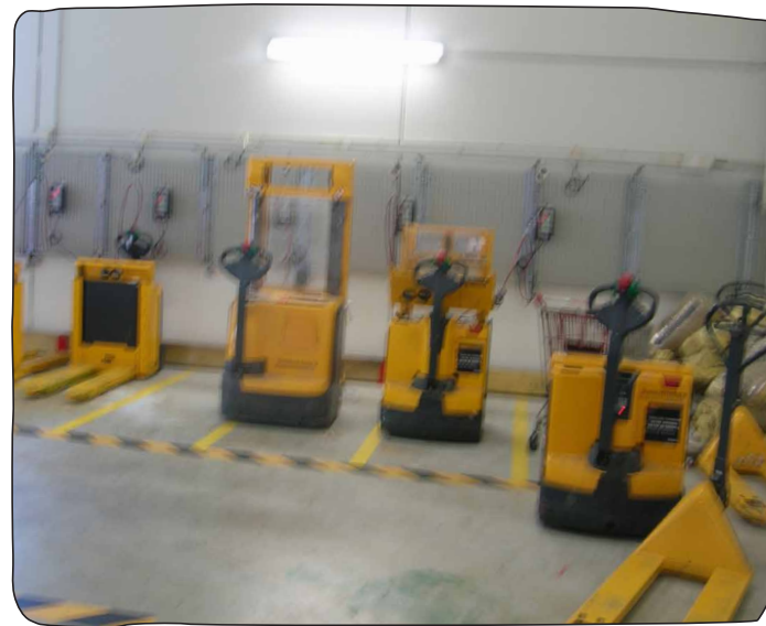
Local de charge batteries
