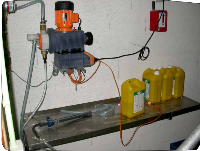
Station de dilution des produits de nettoyage
